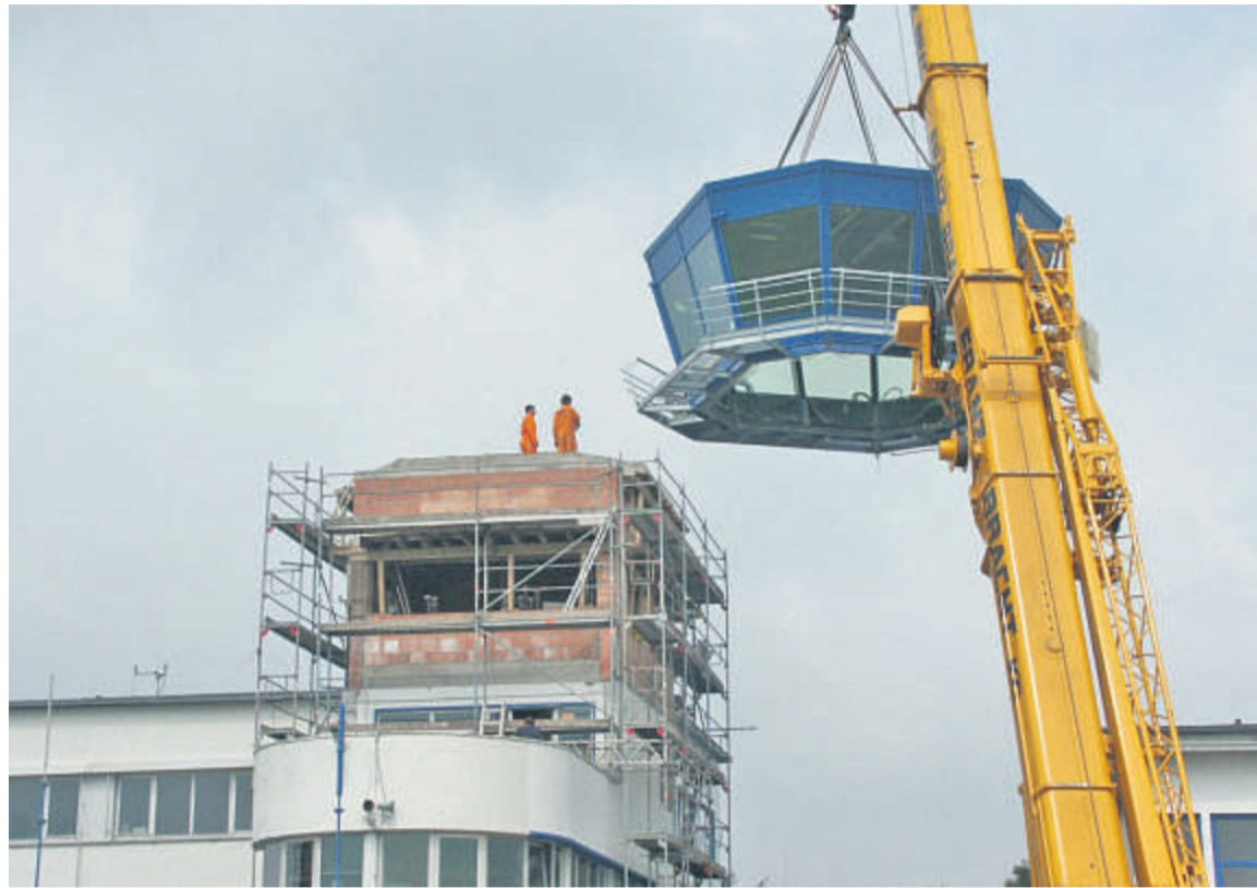
Towerkanzeln sind mitunter so groß, dass die Zepter-Monteur sie vor Ort zusammensetzen müssen. Wie eine Käseglocke setzt der Kran dem Bauwerk, hier der Flughafen Essen-Mülheim dann die Kanzel auf. FOTOS: ZEPTER
